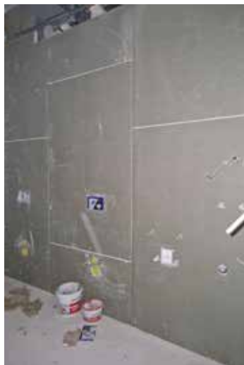
OG INSTALLATION BAD
